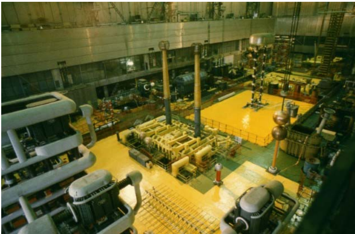
Фото 2. Вид внутри Большого высоковольтного зала
